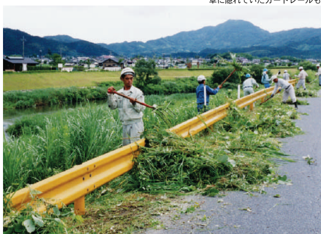
草に隠れていたガードレールも
